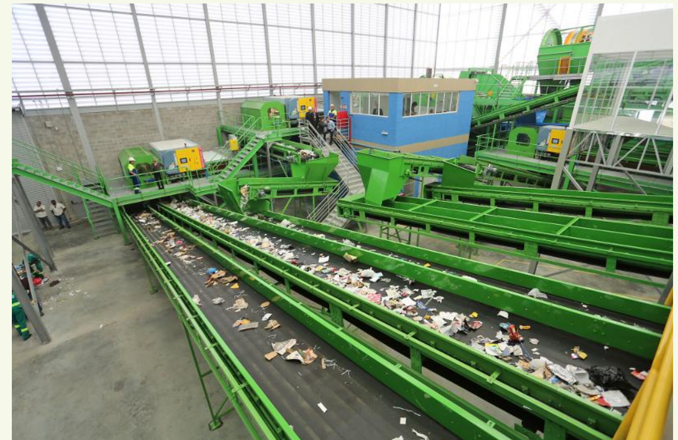
Central de triagem de resíduos sólidos - Fonte: Nossa São Paulo
